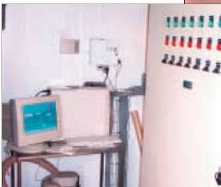
Eltavle og Scada anlæg.
