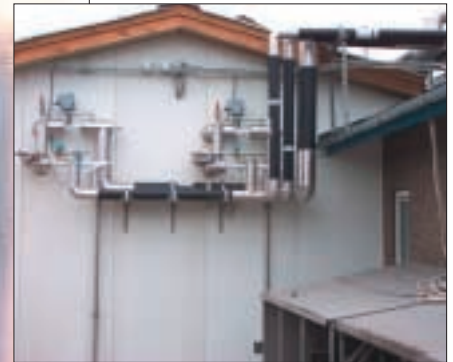
Ventilstationer ved indfrysningstunneller.
